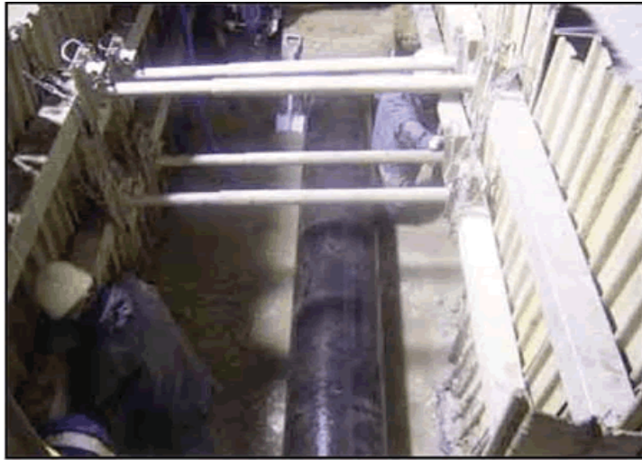
ポリエチレンスリーブ取り外し後（腐食認められず） 写真No3 埋設29年後の管外面の状況
