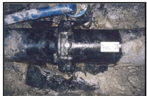
ポリエチレンスリーブ取り外し後（腐食認められず）
